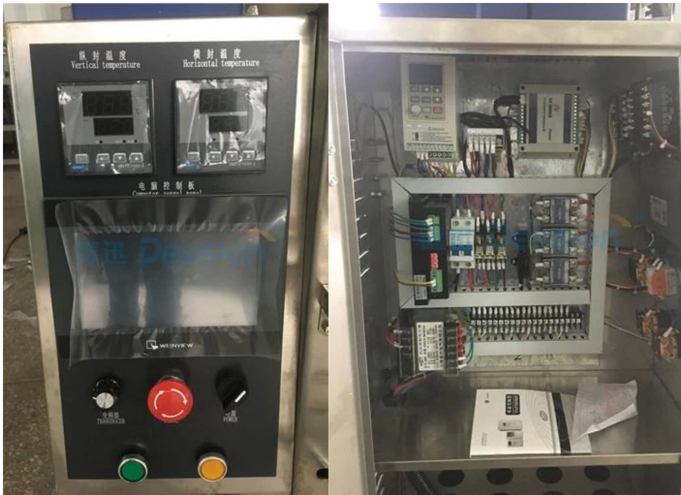
Ceia Telão e Elétrico
