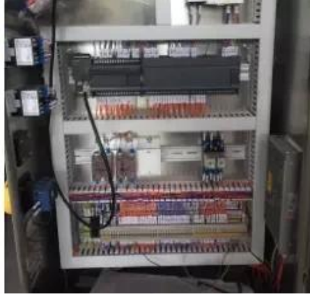
İthal elektrikli parçalar PLC kontrolü, invertör
